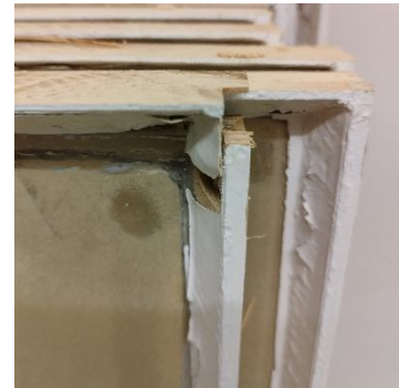
Abb. 32: Asbesthaltige Kittfuge (A)
